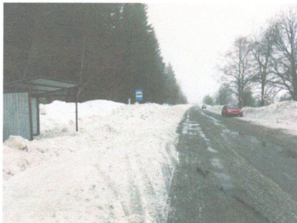
Состояние пункта посадки – высадки обучающихся МОУ СОШ п. Салми в д. Киркиекки на 20.03.2019
